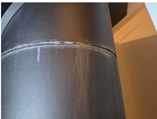
Bild 6: Invändigt, Övervåning, Rinnmärken på skorsten.
